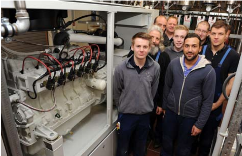
Liefert Strom und Abwärme: Das neue Blockheizkraftwerk hat die Haustechnik komplett selbst installiert.
